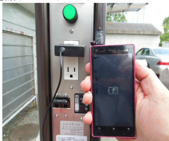
③防災コンセント(AC100V)
